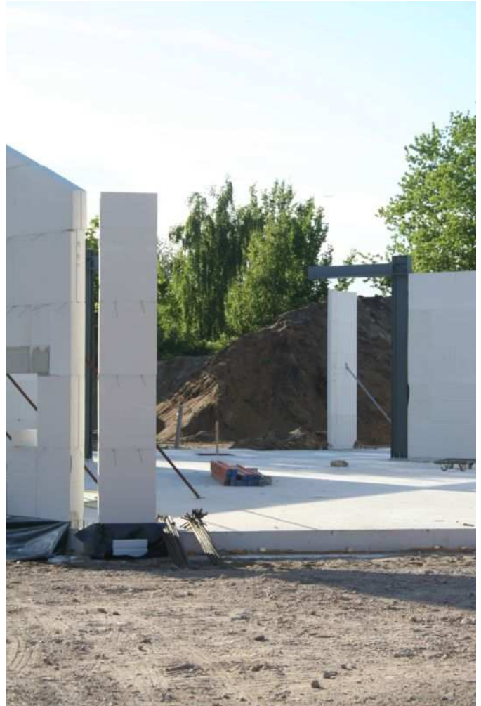
Als laatste een doorkijk door de grote zaal. Ook hier weer staalwerk wat de 'brug' gaat dragen die over de hal gaat lopen met de scheidingswand met de grote zaal.
