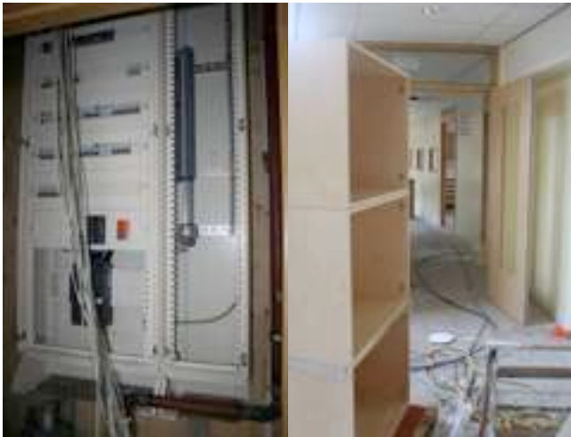
De elektrische installatie is nogal groot... De hoofdzekering gaat tot 100A (dus 22 kW)... vandaar een zwaarder kabeltje nodig van Nuon (links).
