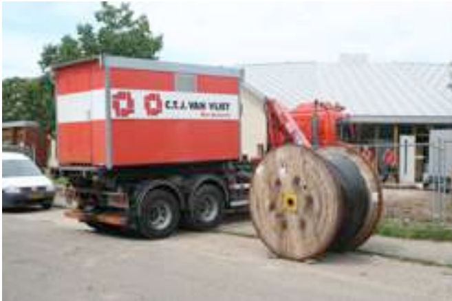
De aannemer begint intussen zijn spullen op te ruimen. De onderaannemers zijn nog wel aan het werk met alle installaties in de school en het schilderwerk. De kabelrol aan de weg bevat de nieuwe voedingskabel voor de school.
