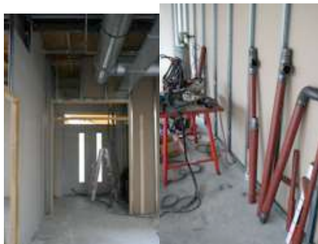
Links: ingang van de BSO vleugel Rechts: de verwarmingspijpen worden afgemaakt op een tijdelijke las/zaag/vijlbank van de installateur.
