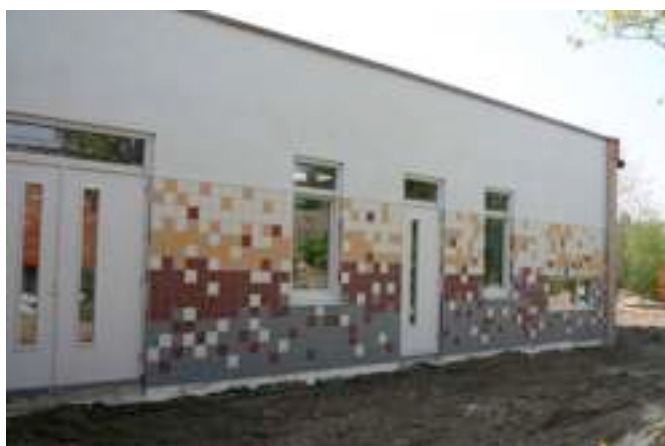
Op het binnenplein is de eerste muur vrij van steigerwerk. Tegels tot bovenkant deur en daarboven schoon stucwerk.
