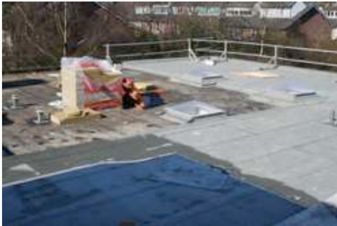
Dit blijft een raar hoekje: Het oude dak van de zaal is gebleven met binnenisolatie en het nieuwe dak met buitenisolatie is er 'tegenaan' geplakt. Ik ben benieuwd of dat 30 jaar gaat houden...
