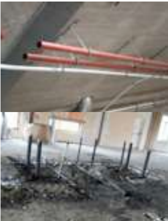
Pijpenwerk onder het plafond en in de vloer van de oude zaal
