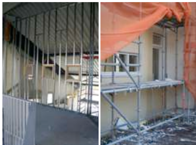
Links: En de laatste keer dat ik van bovenaf zo de grote zaal in kan kijken. Straks zijn er nog 3 raampjes over ☺ Rechts: buiten wordt ook gestuccd om de muren tegelklaar te krijgen.
